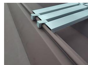
【ボルト締付けの悪い例】
